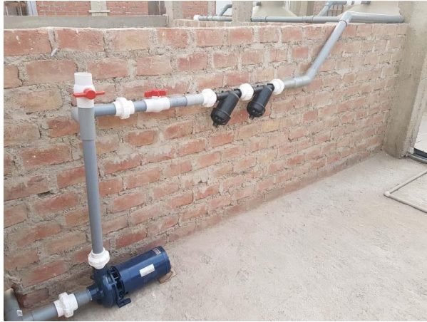
Figura 14. Sistema de bombeo de agua y filtro
