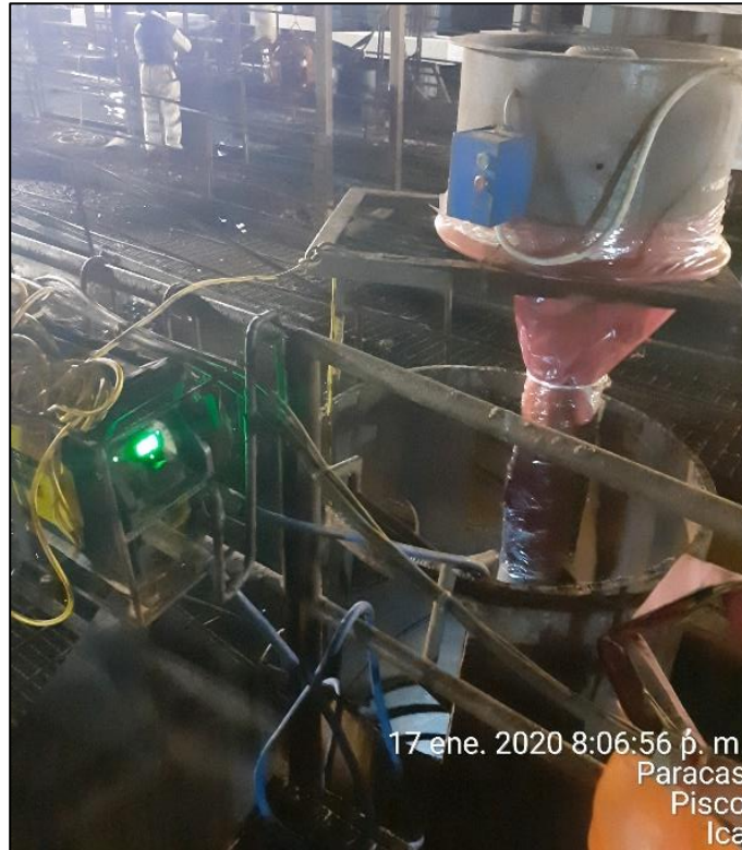
Figura 1: Sistema de Ventilación Utilizado
