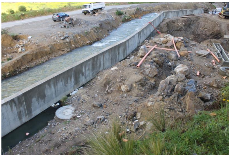
Figura 104. Fuente indirecta por infiltración, unidad colapsada e inoperativa de la comunidad Huancachi.
