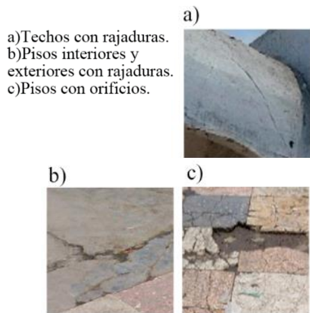
Figura 32. Superficies dañadas en el DPA de Pucusana
