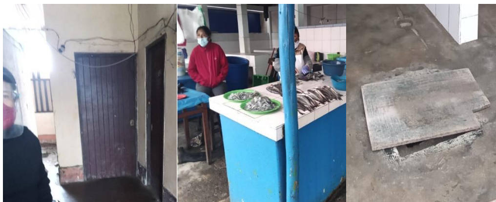
Figura 24. Cables eléctricos expuestos y almacenamiento de agua
