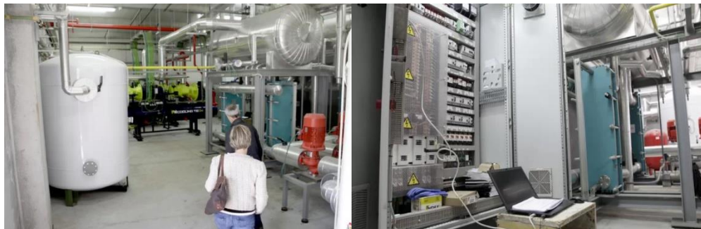
Figura 25. Sistemas eléctricos y redes de agua -Lonja Ribeira
