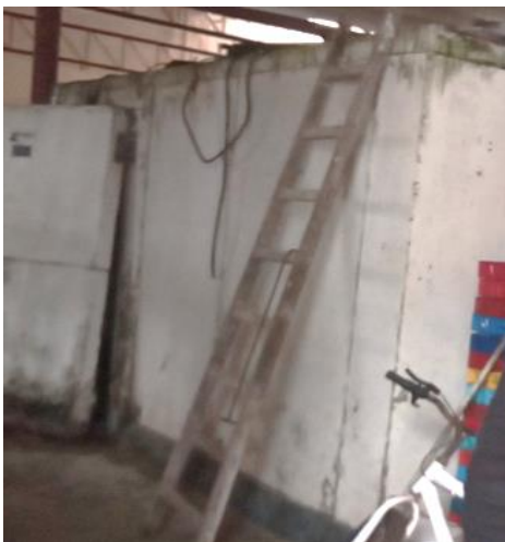
Figura 37. Cámara frigorífico inoperativos en la IPA de Cerro Azul- La Poza
