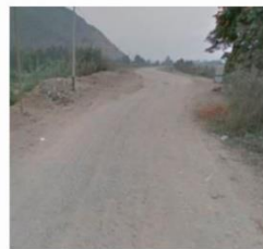
ESTADO DE VIAS INADECUADO
