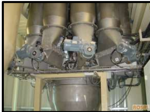
Figura 21. Sistema de dosificación industrial
