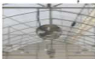
Ventiladores internos Cantidad: 12 und.
