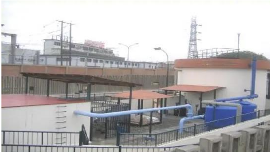
Figura 24. Planta de tratamiento de aguas del Río Surco
