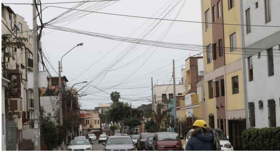
Figura 25. Cables aéreos en zonas monumentales
