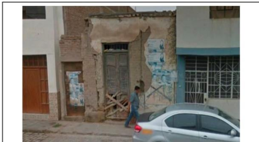
21 Edificación abandonada Vacío Funcional Francisco Cabrera 1262
