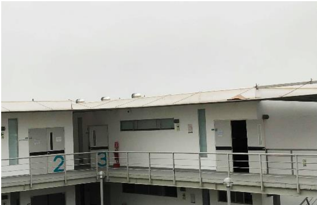
Figura 50: Vista externa de los 3 extractores eólicos instalados en el aula PI-203.
